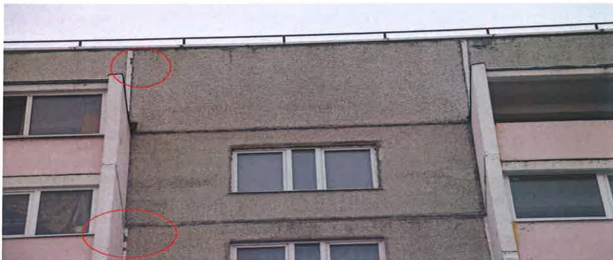
Рис. 20 Трещины и частичное разрушение защитного штукатурного слоя межпанельного стыка.
