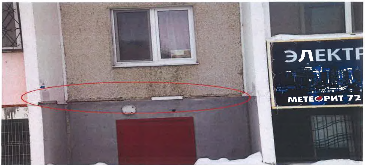
Рис. 15 Отсутствует защитный штукатурный слой межпанельного стыка. Происходит попадание осадков на теплоизоляционный материал.
