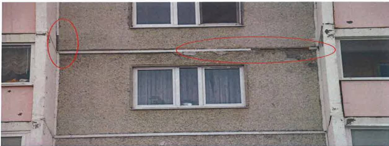
Рис. 23 Трещины и частичное разрушение защитного штукатурного слоя межпанельного стыка.
