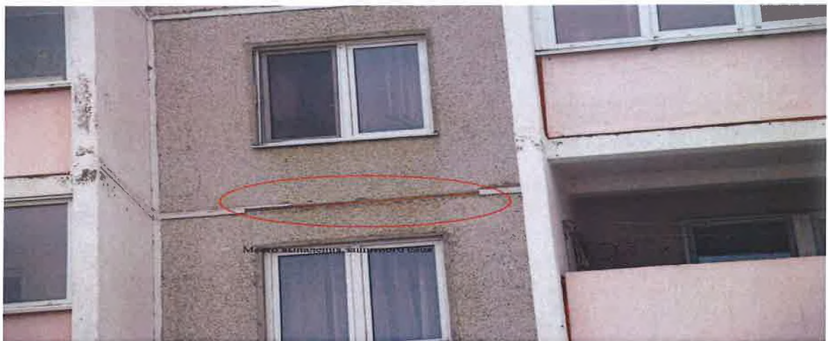
Рис. 13 Участок выпадения защитного штукатурного слоя в межпанельном стыке.
