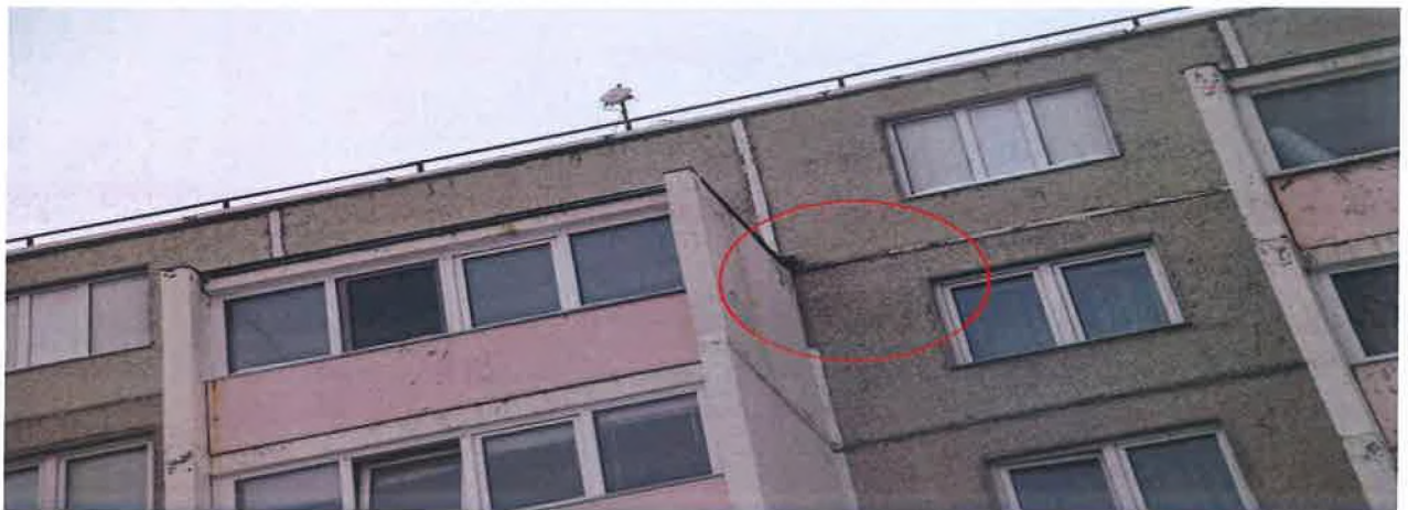
Рис. 18 Участок выпадения защитного штукатурного слоя межпанельного стыка.
