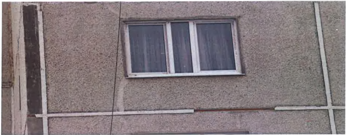
Рис. 13 Участок выпадения защитного штукатурного слоя в межпанельном стыке.
