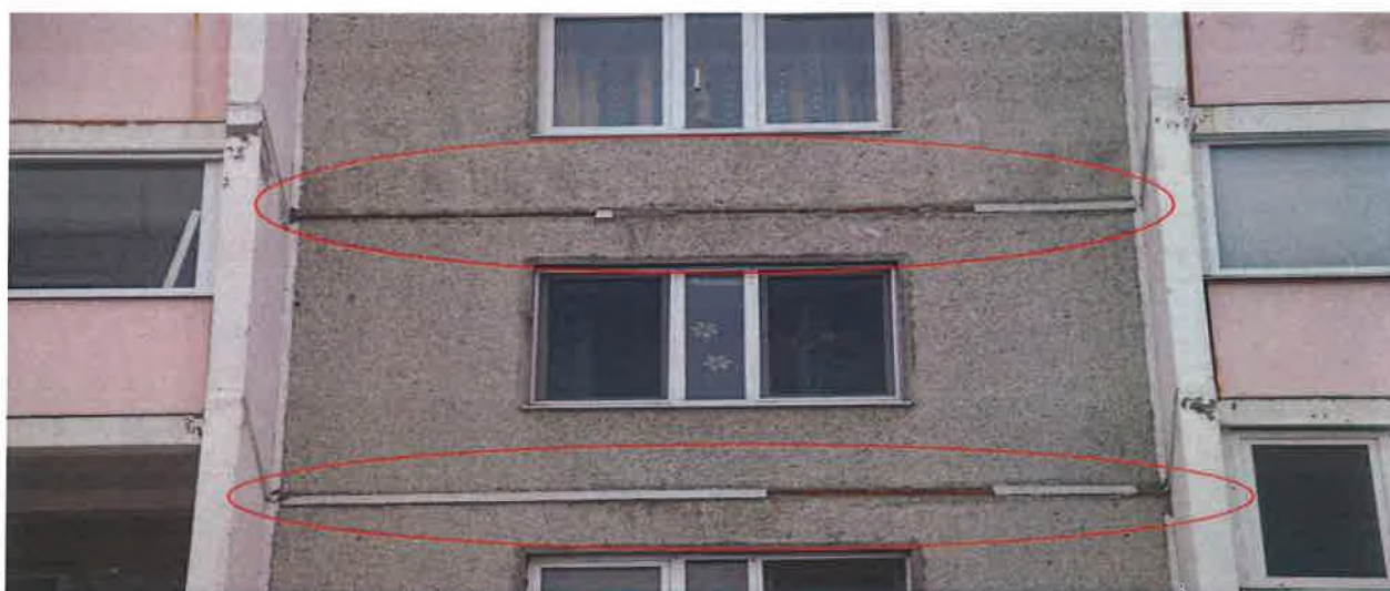
Рис. 22 Трещины и частичное разрушение защитного штукатурного слоя межпанельного стыка.
