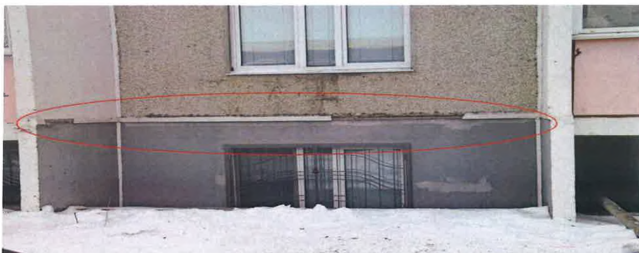
Рис. 24 Трещины и частичное разрушение защитного штукатурного слоя межпанельного стыка.
