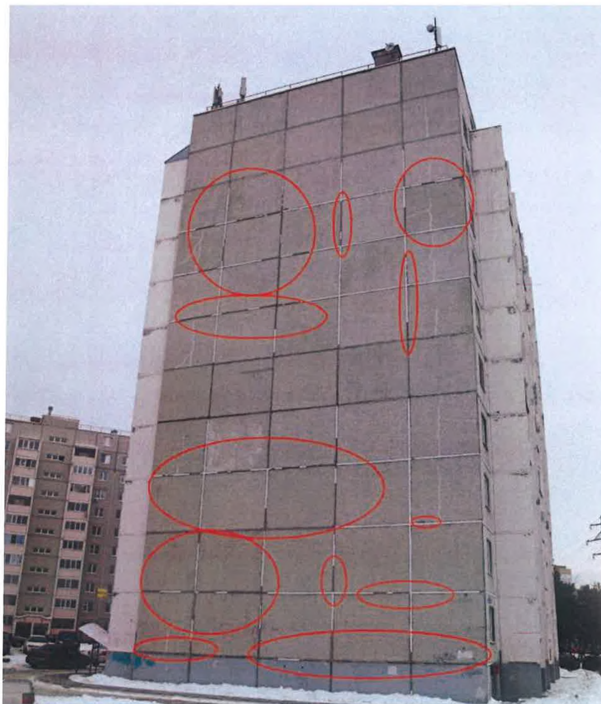
Рис. 12 Общий вид фасада по оси В-Г с выделением дефектных участков в межпанельных стыках.
