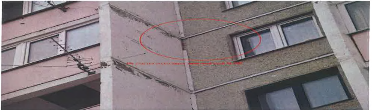
Рис. 17 Участок выпадения защитного штукатурного слоя межпанельного стыка.
