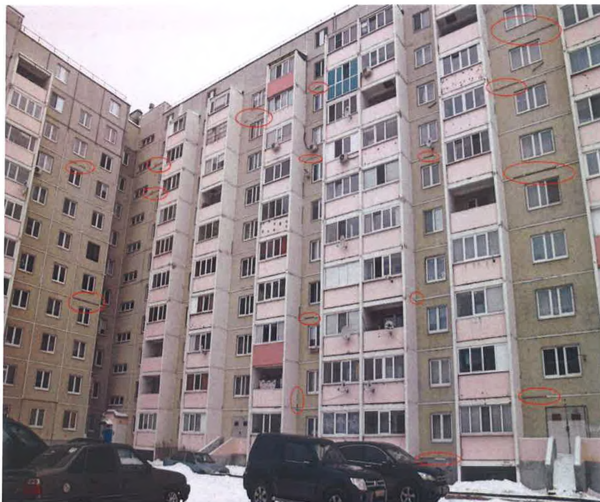
Рис. 11 Общий вид дворового фасада по оси 7-1с выделением дефектных участков в межпанельных стыках.
