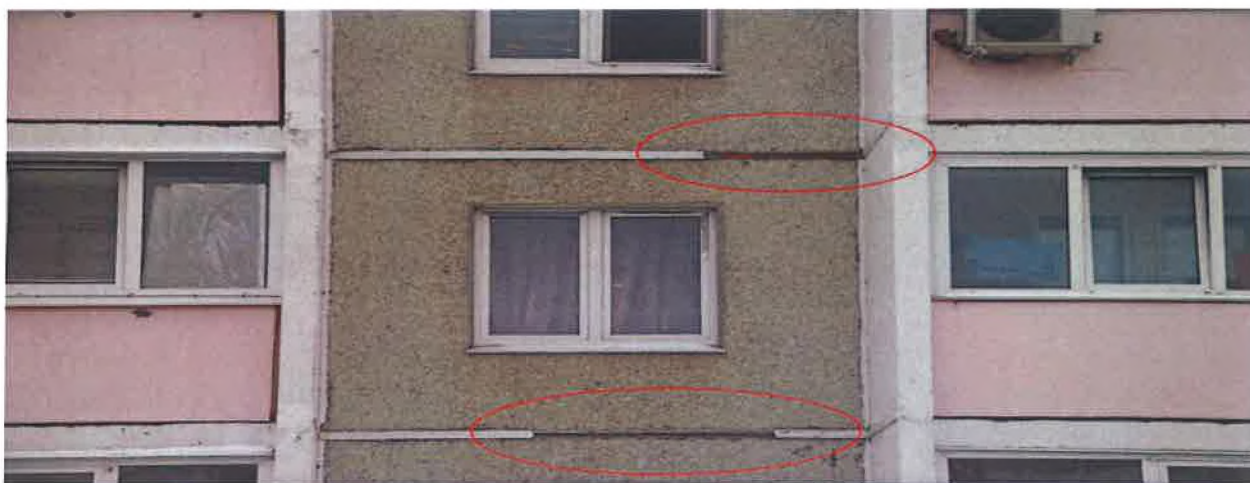
Рис. 26 Трещины и частичное разрушение защитного штукатурного слоя межпанельного стыка.
