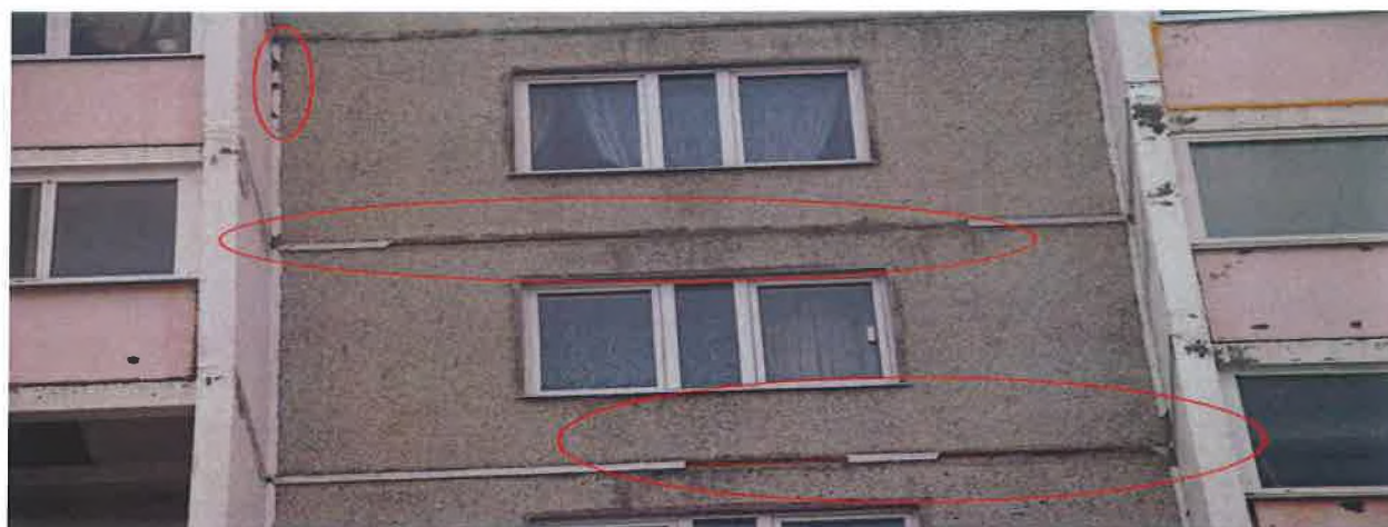
Рис. 21 Трещины и частичное разрушение защитного штукатурного слоя межпанельного стыка.
