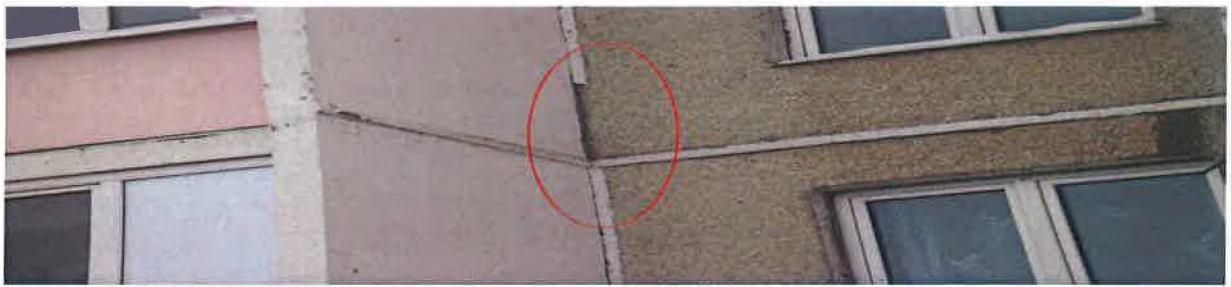
Рис. 16 Участок выпадения защитного штукатурного слоя межпанельного стыка.
