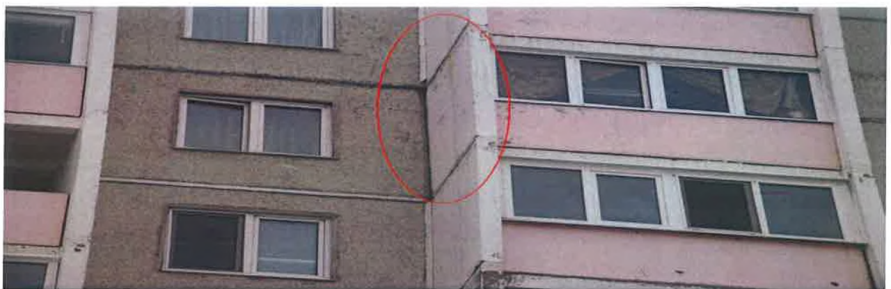
Рис. 19 Участок выпадения защитного штукатурного слоя межпанельного стыка.
