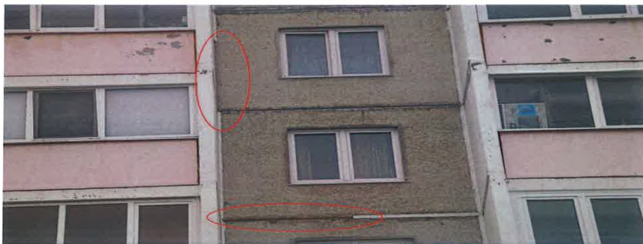
Рис. 25 Трещины и частичное разрушение защитного штукатурного слоя межпанельного стыка.
